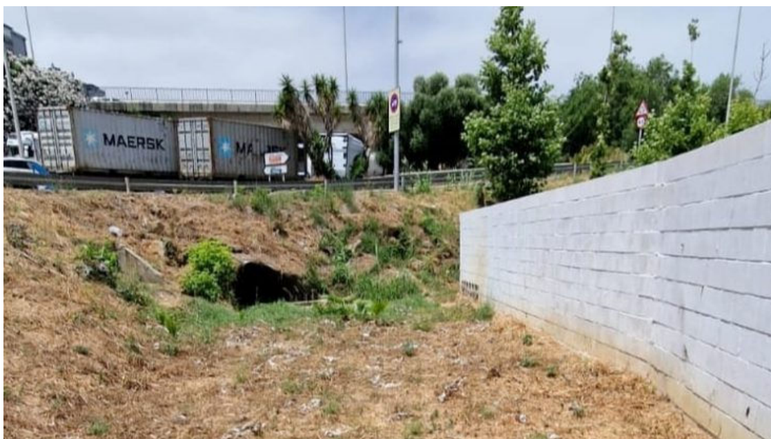
Denuncia por el estado de una tubería de Emalgesa. / FOTO: PSOE
